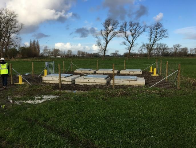
Figuur 3: Voorbeeld van een inspectieput
